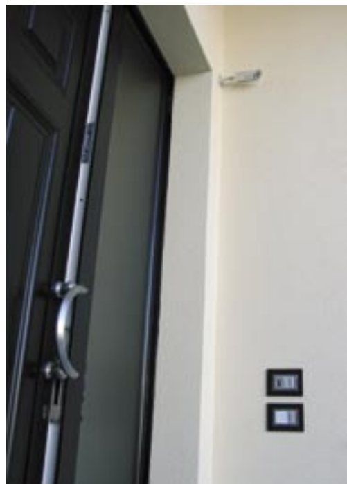
Porta di ingresso: riscontro elettrico, sul bordo si intravede la barriera infrarosso e nella zona interruttori il punto chiave e il lettore di prossimità (sopra il campanello), mentre una mini telecamera è puntata sul vialetto di accesso
